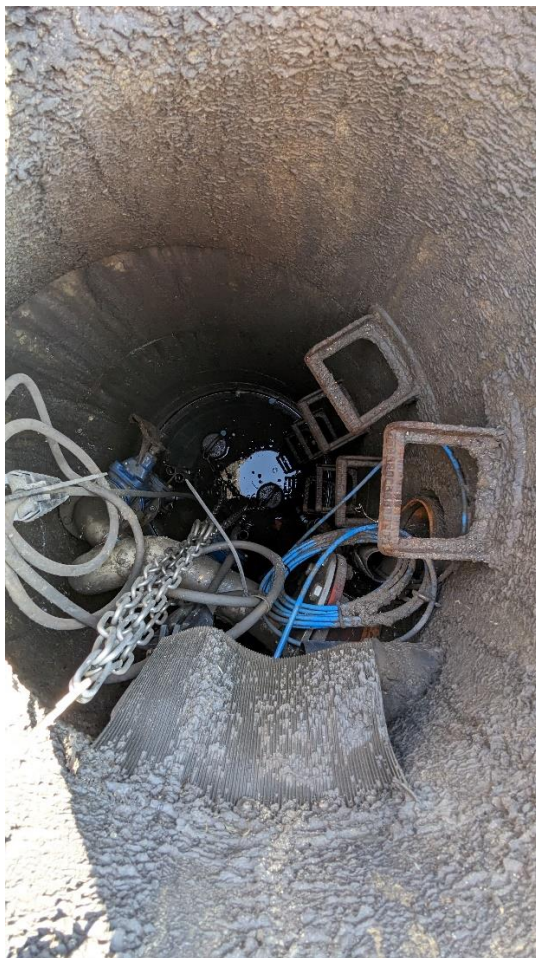
Abbildung 2: Pumpwerk Wendelsteiner Straße
